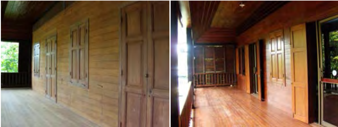
ภาพที่ 5.1-5 ผนัง ประตู หน้าต่าง ชั้น 2 ของบ้านพักพระสงฆ์ (ซ้าย)ก่อนการบูรณะ (ขวา)หลังการบูรณะ
