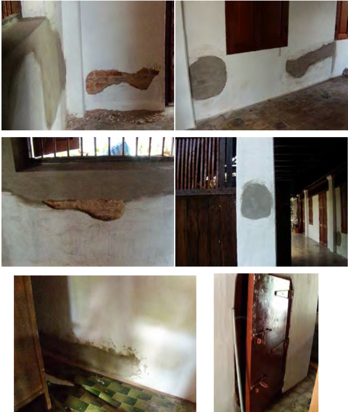
ภาพที่ 5.1-8 ปูนกะเทาะบริเวณผนังชั้นล่าง
