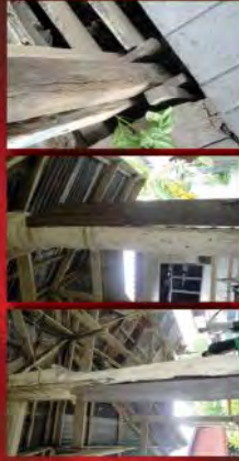
เสาไม้ชำรุด ยุบงออง ลอยจากพื้นดิน (ก่อนการบูรณะ)
