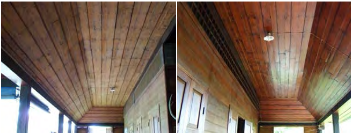
ภาพที่ 5.1-3 ฝ้าเพดานชั้น 2 ของบ้านพักพระสงฆ์ (ซ้าย)ก่อนการบูรณะ (ขวา)หลังการบูรณะ
