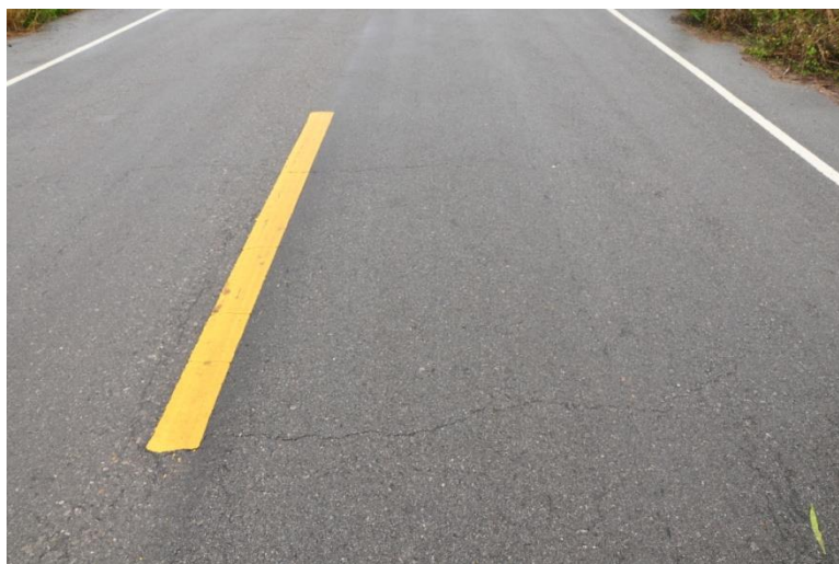
รูปที่ 1-1 รอยแตกร้าวตามแนวขวางและแนวยาวเป็นลักษณะบล็อก (Block cracking) บนถนนที่บูรณะด้วยวิธีการนำวัสดุชั้นโครงสร้างทางเดิมมาปรับปรุงคุณภาพโดยการผสมเย็นแบบในที่ (Cold In-Place Recycling) โดยใช้ซีเมนต์เป็นสารผสมเพิ่ม
