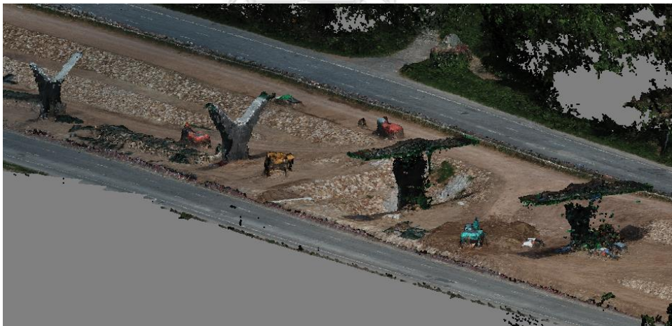
รูปที่ 5.13 แบบจำลองสภาพพื้นที่แสดงกิจกรรมก่อสร้าง
