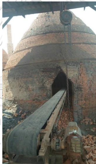
รูปที่ 2.13 ภาพเตาเผารูปทรงโดมสำหรับการเผาอิฐดินเผาก่อสร้างจังหวัดชลบุรี [30]
