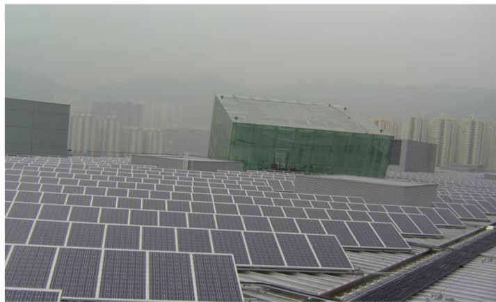
รูปที่ 2.36 ระบบเซลล์แสงอาทิตย์บนดาดฟ้าของห้างเทสโก้โลตัส สาขาพระราม1 [14]
