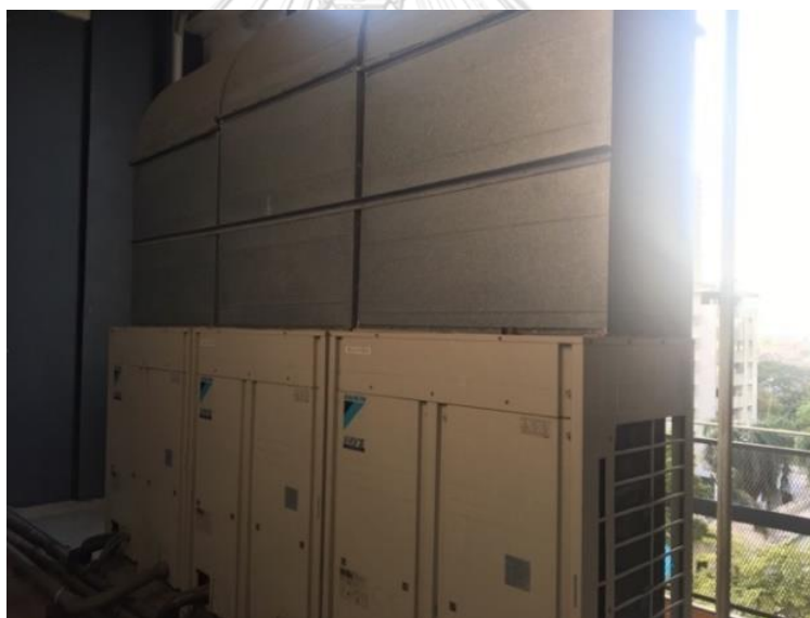
รูปที่ 4.3 รูปถ่ายลักษณะของตัว Outdoor units ของระบบปรับอากาศ VRF ที่ใช้ภายในอาคารเฉลิมราชกุมารี 60 พรรษา
