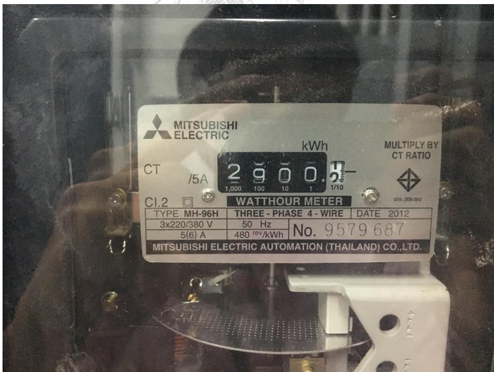
จ.12 หน่วยวัดค่าไฟฟ้าจากมิเตอร์ของห้องสมุดชั้นที่ 2 ณ วันที่ 28 มิถุนายน 2562
