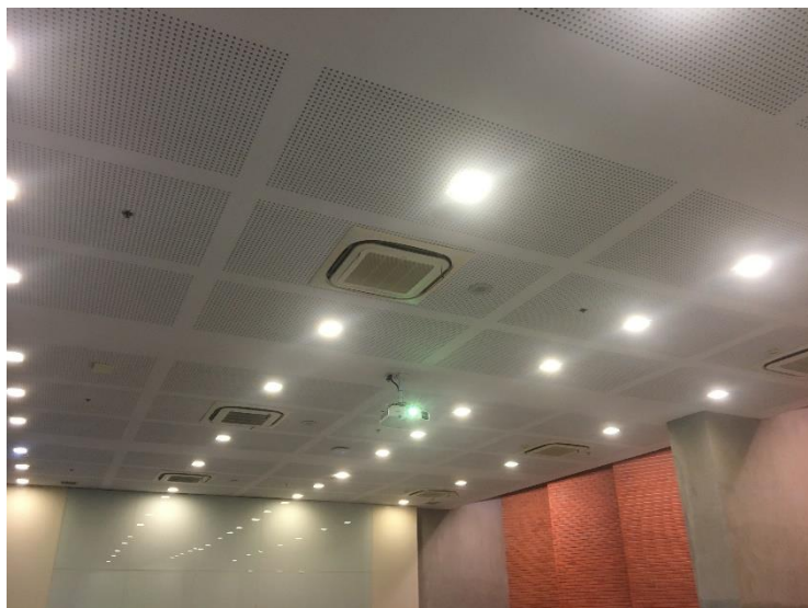
รูปที่ 4.4 ลักษณะของตัว Indoor Units ของระบบปรับอากาศ VRF ที่ใช้ภายในอาคารเฉลิมราชกุมารี 60 พรรษา
