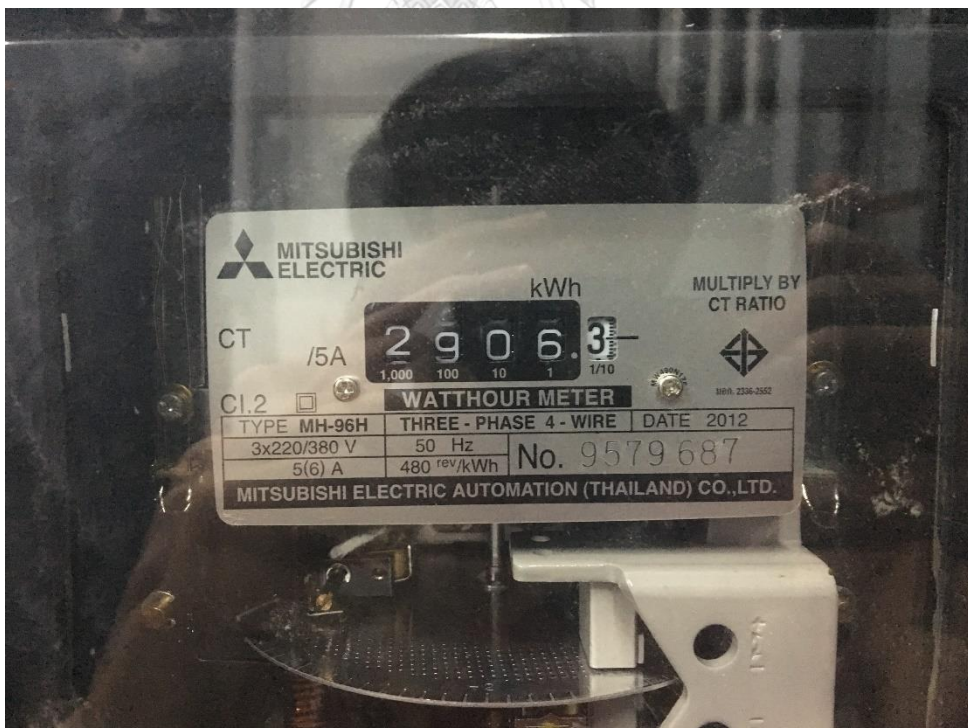
จ.14 หน่วยวัดค่าไฟฟ้าจากมิเตอร์ของห้องสมุดชั้นที่ 2 ณ วันที่ 30 มิถุนายน 2562
