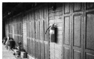
ที่เก็บถังดับเพลิง มีจำนวนไม่เพียงพอ
