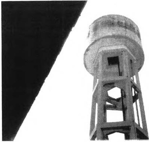
รูปภาพที่ 4 - 3 บ่อสูบน้ำบาดาลหมู่ที่ 1
