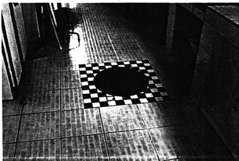
ภาพที่ 4.227 แสดงปัญหาภายหลังการต่อเติม
