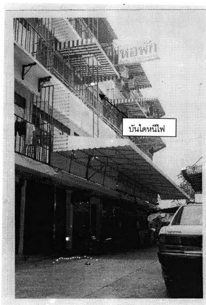
รูปที่ 6.14 แสดงลักษณะของบันไดหนีไฟที่ติดตั้งบนอาคารที่ปักให้เข้า
