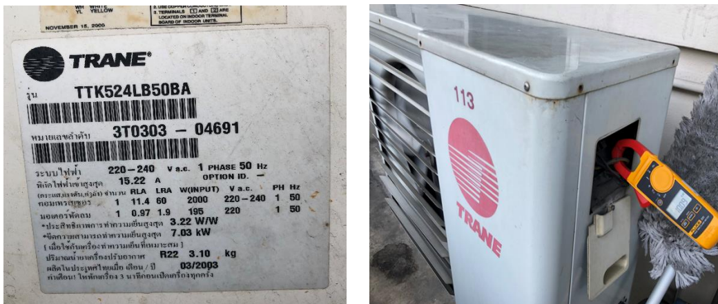
Figure 18 เครื่องปรับอากาศแบบแยกส่วน
