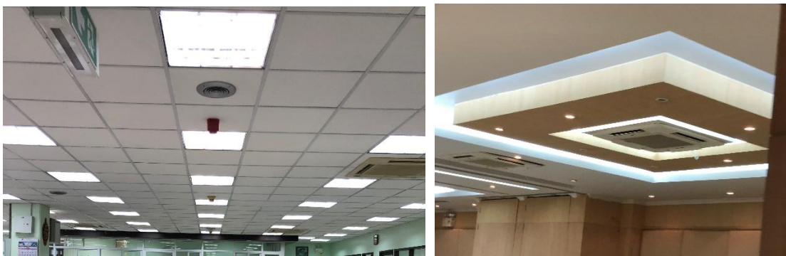
Figure 15 รูปแบบของ โคมไฟภายในห้องทำงาน และห้องประชุม เป็น โคมไฟฟลูออเรสเซนต์ และ โคมไฟดาวน์ไลท์
