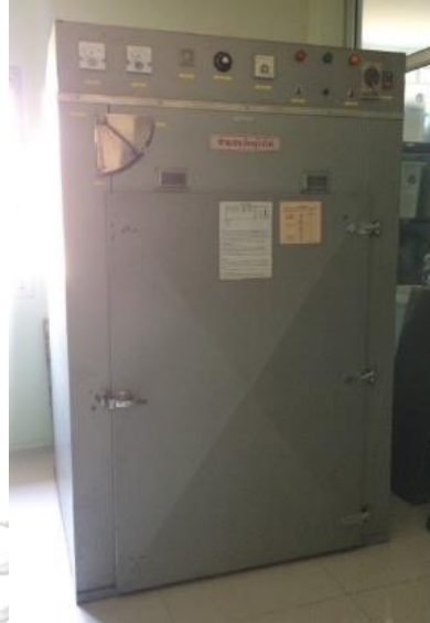
รูปที่ 7 ตู้ไฟฟ้า 1 HP
