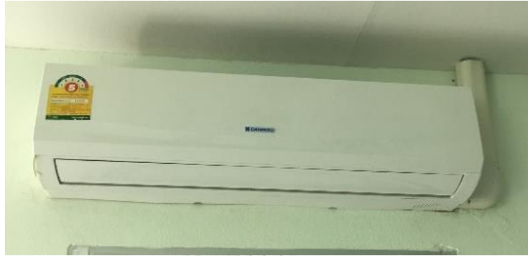
รูปที่ 17 เครื่องปรับอากาศ
