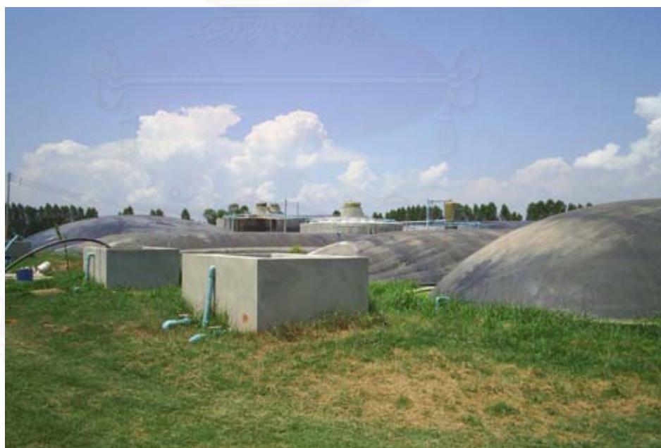
รูปที่ 9 แสดงลักษณะของระบบก๊าซชีวภาพของหน่วยบริการก๊าซชีวภาพ BAU (Biogas Advisory Unit)
