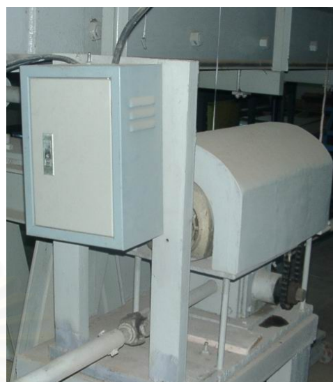
รูป ก-2 มอเตอร์ไฟฟ้าสำหรับปรับแม่แรง
