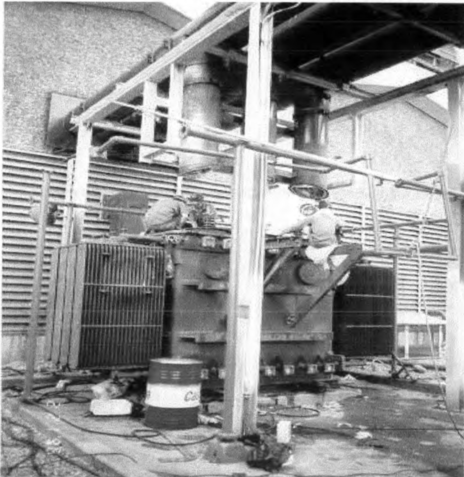
รูปที่ ข 6 การถอดชิ้นส่วนของหม้อแปลงไฟฟ้าเพื่อต่อเข้าอุปกรณ์ปรับสภาพน้ำมัน
