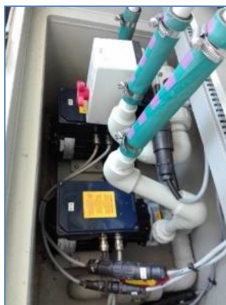
รูปที่ 2-17 ปั๊มที่ติดตั้งในแบตเตอรี่ VRF
