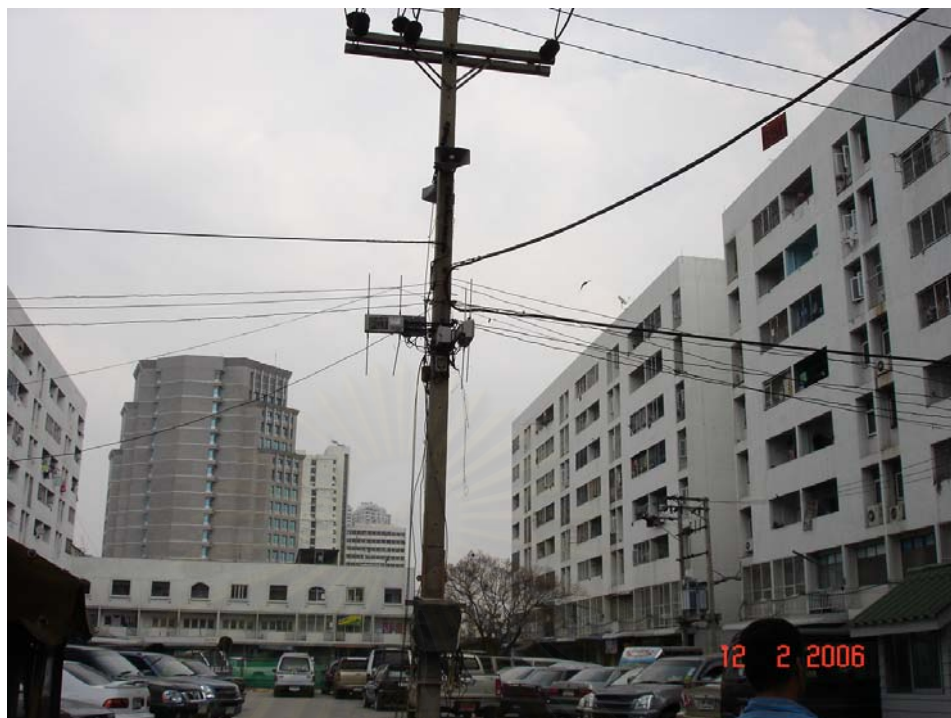
ภาพประกอบที่ 4.8 แสดงระบบไฟฟ้า และจุดตั้งลำโพงกระจายข่าวภายในชุมชนเทพประทาน
