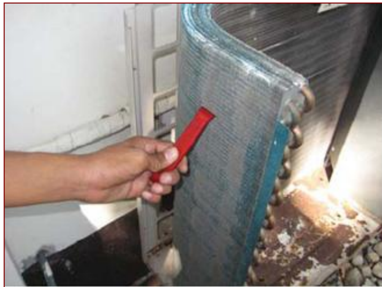
รูปที่ 4.7 การใช้หวีฟันปรับแต่งให้แผ่นฟินตั้งตรงตามเดิม ในกรณีที่ ถ้าแผ่นฟินที่แผง ระบายความร้อนล้ม
