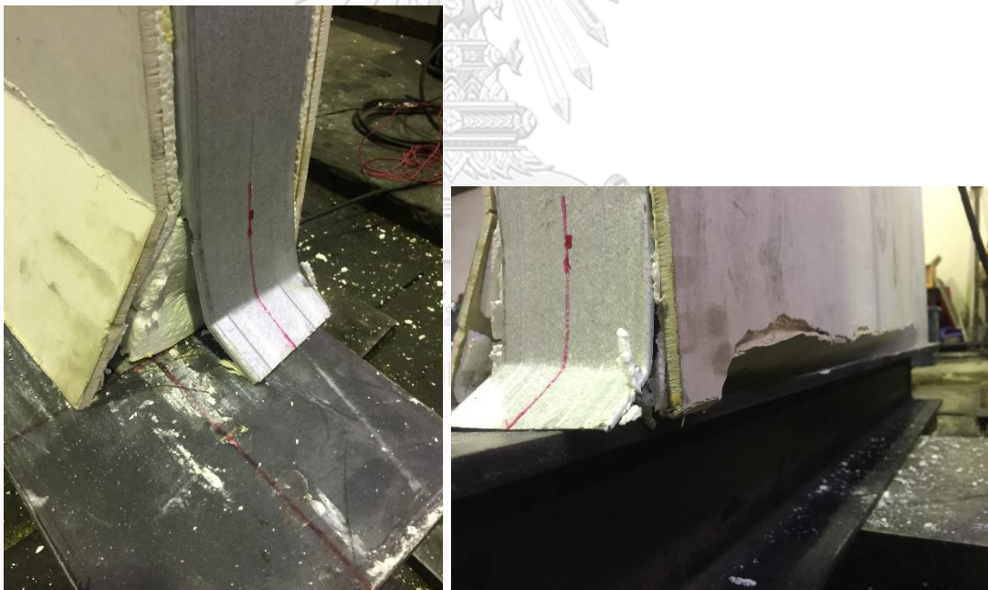
รูป 4-20 การฟุ้งของแผ่นประกอบที่เป็นฉนวนโฟมแบบมีเหล็ก
