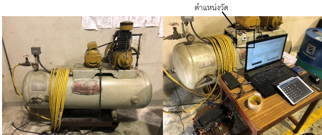
รูปที่ 4.11 เครื่องคอมเพรสเซอร์แบบ 1 ลูกสูบ และการติดตั้งระบบการวัด
