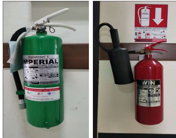
รูปที่ 3.3 ถังดับเพลิง
