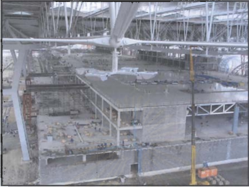
รูปที่ 1.6 งานก่อสร้างอาคารผู้โดยสาร ถ่ายเมื่อวันที่ 3 กันยายน 2547 (ที่มา : http://www.suvarnabhumiairport.com )
