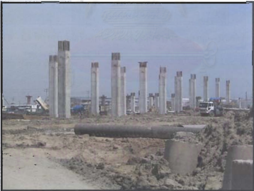
รูปที่ 1.7 งานก่อสร้างถนนยกระดับด้านหน้าอาคารผู้โดยสาร ถ่ายเมื่อวันที่ 25 สิงหาคม 2547 (ที่มา : http://www.suvarnabhumiairport.com )
