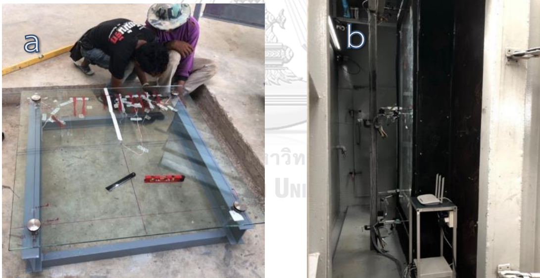
รูปที่ 3-6 การติดตั้งกระจกเข้ากับโครงเหล็กฐานรองรับ ด้วยตัวยึดต่อกระจกที่ใช้ในการ ทดสอบ (a) กระจก 1200x1200 mm ติดตั้งแนวนอน (b) กระจก 1200x2400 mm ติดตั้งแนวตั้ง
