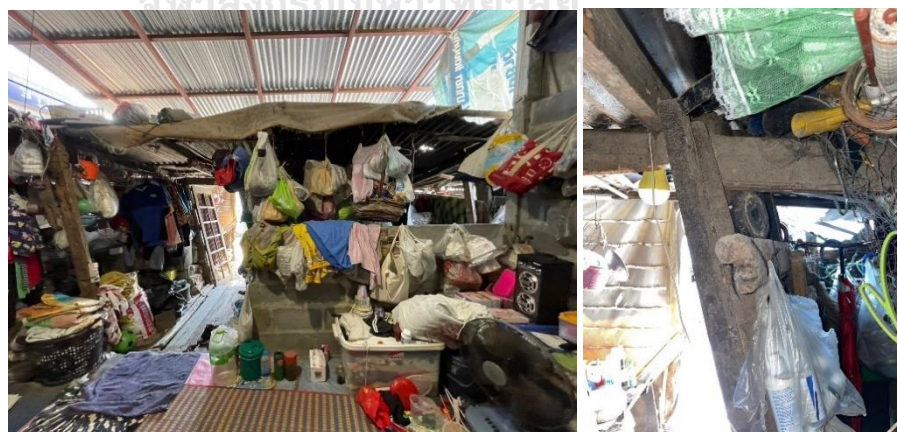
ภาพ 6.3 บ้าน S7 สภาพบ้านทั่วไปทรุดโทรมจากปัญหาการเสื่อมสภาพและโครงสร้างเสาไม้ชำรุด (ภาพใหม่) ที่มา: ผู้วิจัย (2566)
