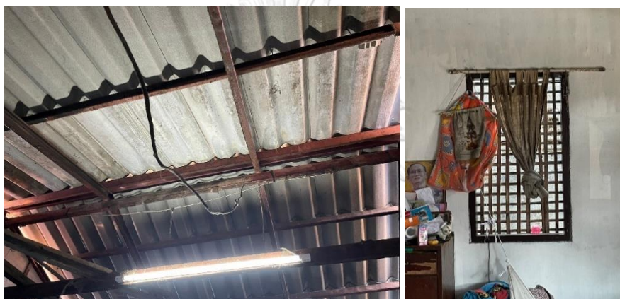
ภาพ 6.4 บ้าน S9 ปัญหาการติดตั้งและใช้วัสดุไม่ถูกต้อง หลังคารั่ว และบ้าน S6 ปัญหาใช้วัสดุไม่เหมาะสม ที่มา: ผู้วิจัย (2566)
