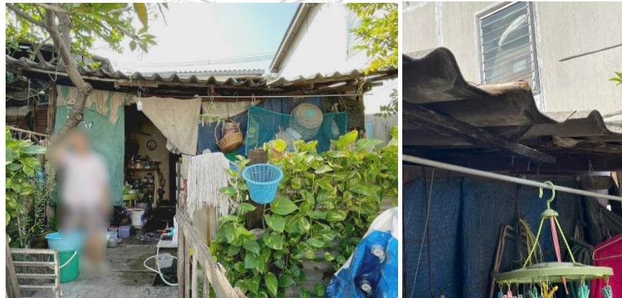
ภาพ 6.2 บ้าน S3 สภาพบ้านทั่วไปทรุดโทรม และโครงสร้างหลังคาชำรุด (ภาพใหม่) ที่มา: ผู้วิจัย (2566)
