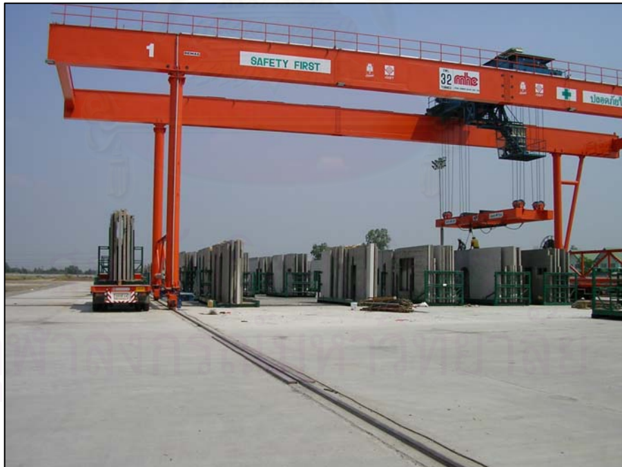
รูปที่ 4.10 การขนส่งชิ้นส่วนคอนกรีตสำเร็จรูปของหน่วยงานโรงงานผลิต
