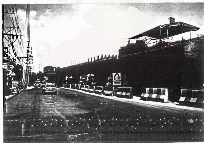
รูปภาพที่ 4-6 บริเวณการก่อสร้างสะพานลอยข้ามแยก คาดว่าจะแล้วเสร็จปลายปี 2542 (สี่แยกถนนตก)
