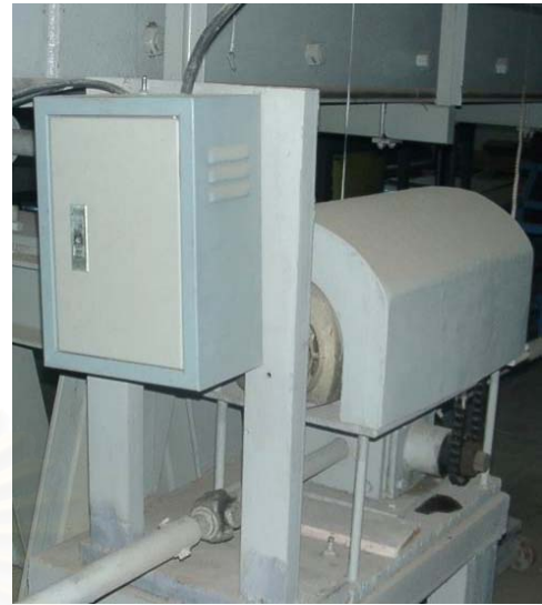
รูป ก-2 มอเตอร์ไฟฟ้าสำหรับปรับแม่แรง
